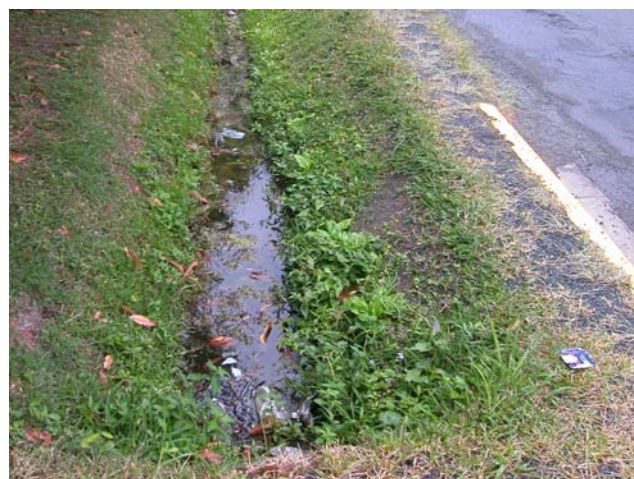
Caniveau bouché, gîte à Culex (Photo IPNC)
